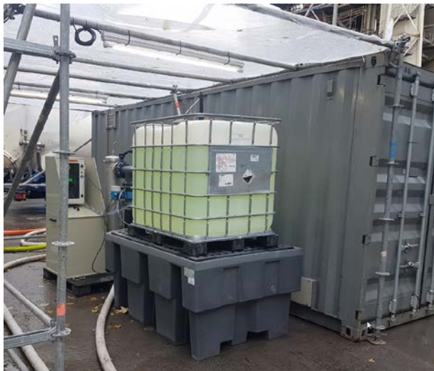
Osmoseanlage neben Achteckbehälter
